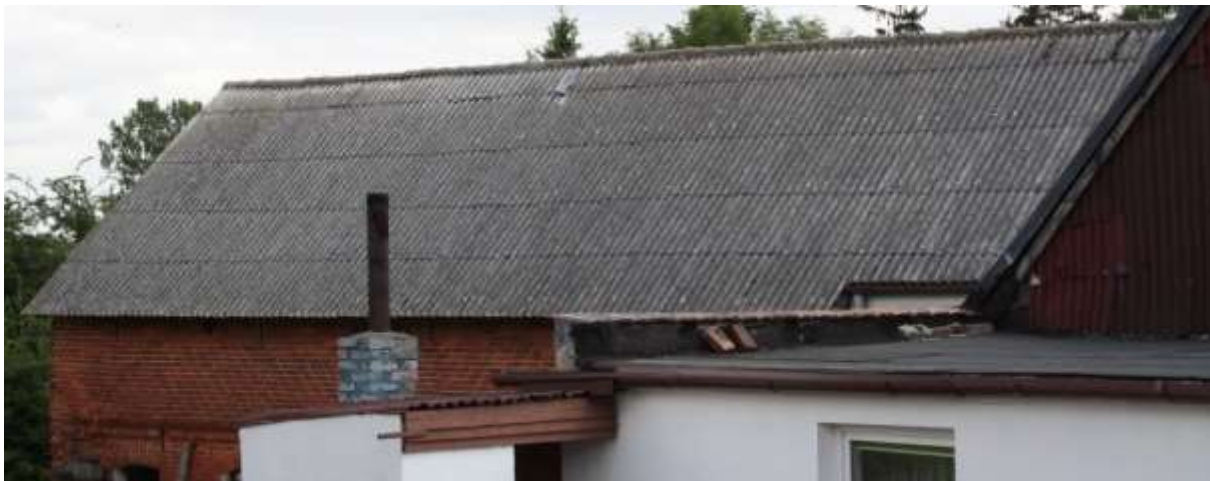
Fot. 8. Zdegradowane obiekty budowlane, w tym o przeznaczeniu mieszkaniowym z dominującym pokryciem dachowym zawierającym azbest
