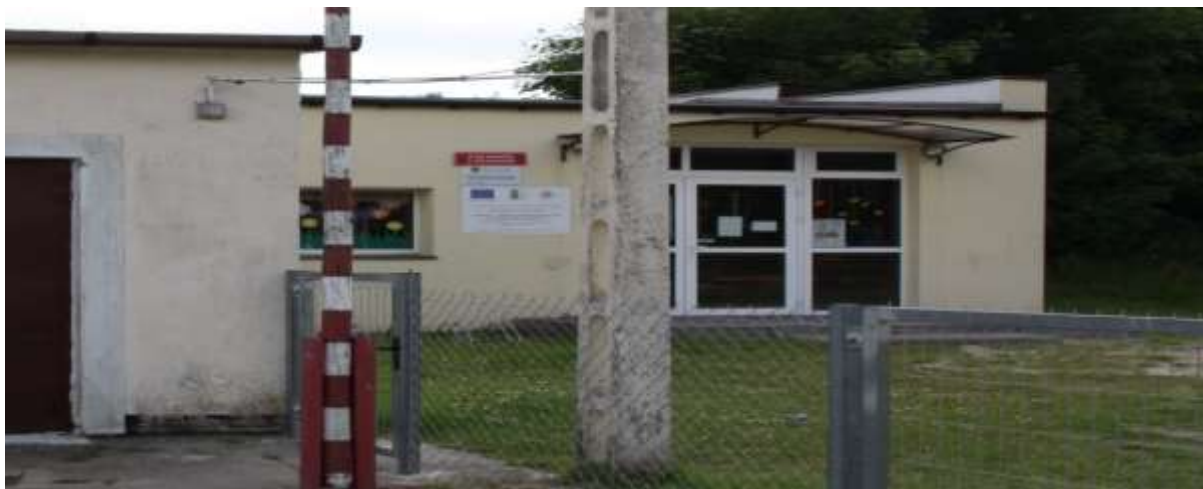
Fot. 6. Nieczynny z powodu zagrożenia zawaleniem budynek z przeznaczeniem na funkcje społeczno-integracyjne
