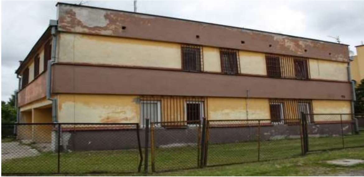
Fot. 27. Zdegradowany budynek Policji w Malechowie
