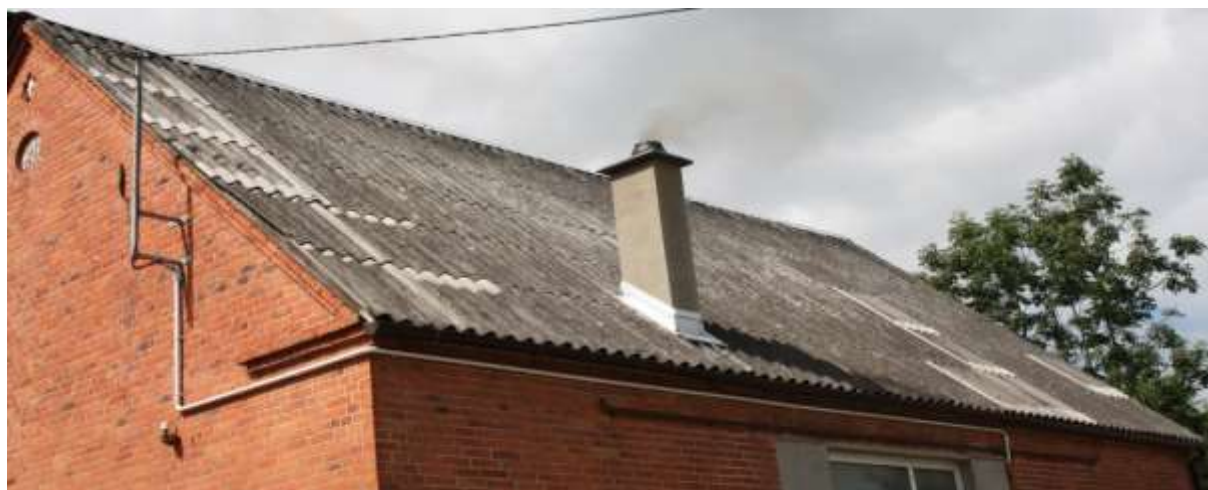
Fot. 10. Zdegradowane objekty budowlane, w tym o przeznaczeniu mieszkaniowym z występującym pokryciem dachowym zawierającym azbest
