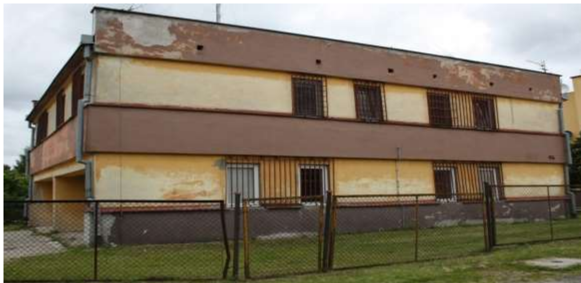
Fot. 27. Zdegradowany budynek Policji w Malechowie
