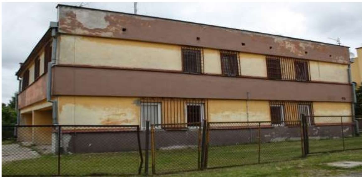
Fot. 27. Zdegradowany budynek Policji w Malechowie
