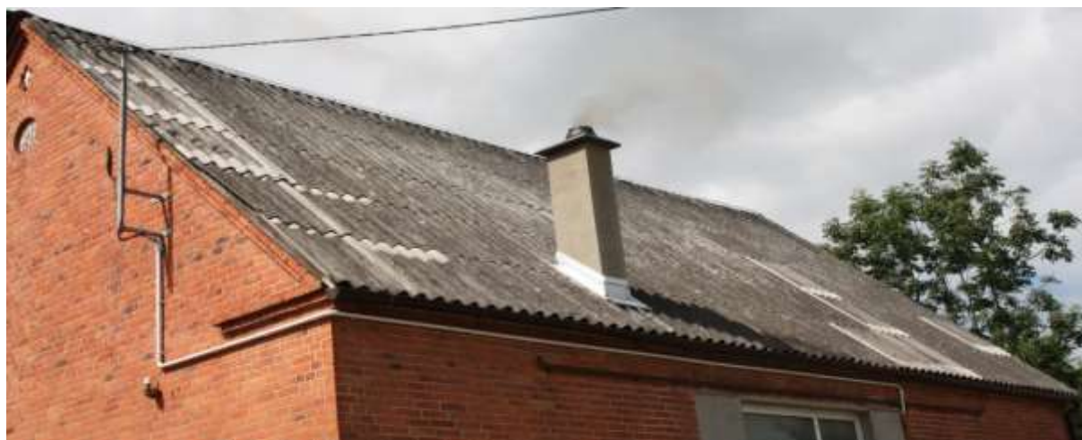
Fot. 10. Zdegradowane obiekty budowlane, w tym o przeznaczeniu mieszkaniowym z występującym pokryciem dachowym zawierającym azbest
