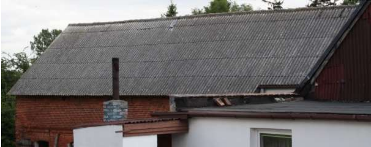
Fot. 8. Zdegradowane obiekty budowlane, w tym o przeznaczeniu mieszkaniowym z dominującym pokryciem dachowym zawierającym azbest
